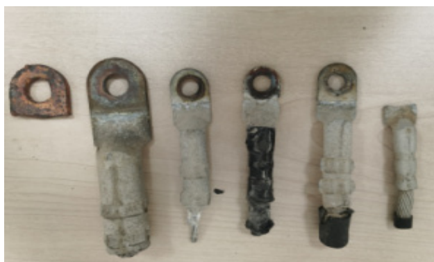
图 3 “闪光焊、摩擦焊”线夹断裂故障
