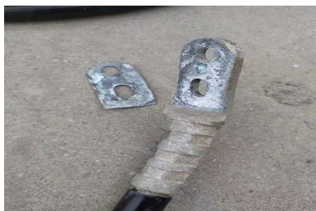
图 4 “钎焊”线夹断裂故障
