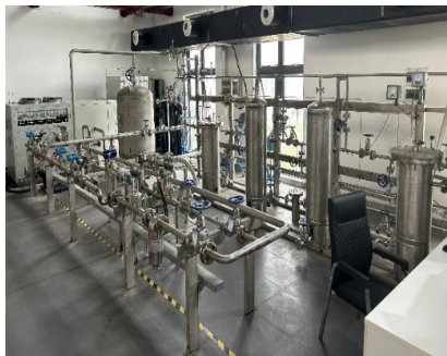
图 2 重水冷却系统实验平台照片
